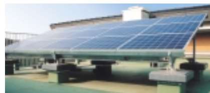
太陽光発電設備
