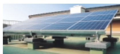
太陽光発電設備
