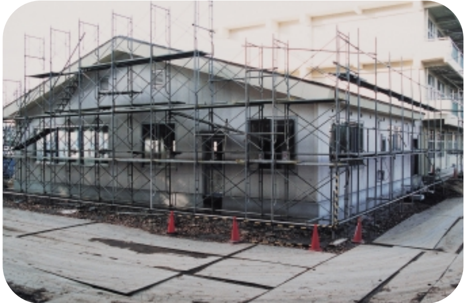
建設が進む(仮)本町田学童保育クラブ(緑ヶ丘学童保育クラブから4月に移転します)
