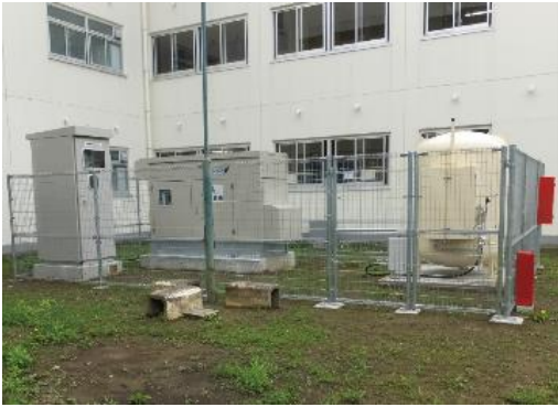
既存発電設備
