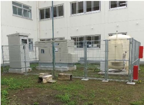
既存発電設備
