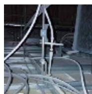
天井裏設置例
