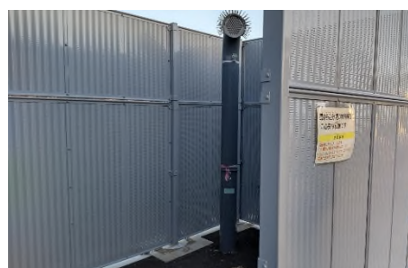
写真7 ガス抜き管 （池の辺地区）
