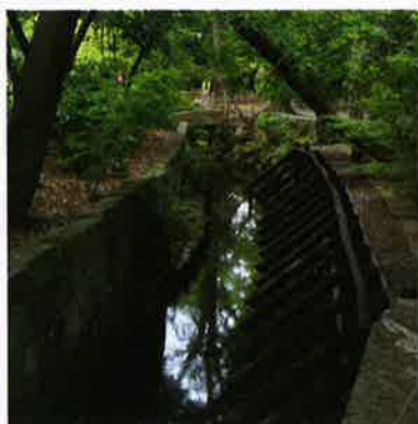
図3 「伝法院庭園」北側池泉を見る。護岸が崩れかけており応急修理でしのいでいる
