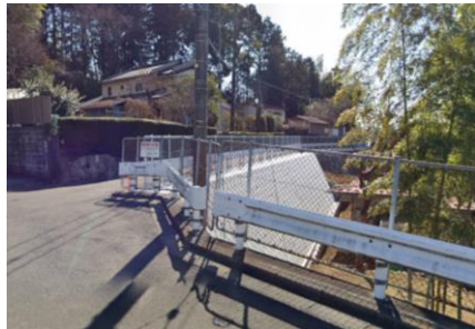
法面等の整備に伴う危険性除去による除外（相原町）
