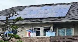
戸建住宅のソーラーパネル
