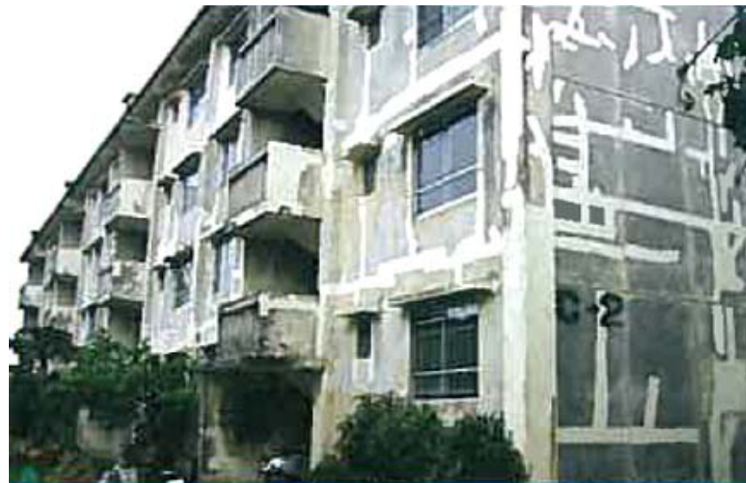
①老朽化した住棟外観(海岸に近く塩害等により老朽化が進行)
