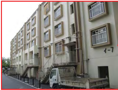
～住宅棟～ 老朽化や社会的劣化が進みつつある
