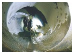
穴が開いた下水道管
