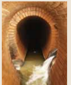
神田下水 (写真提供・東京都下水道局)
