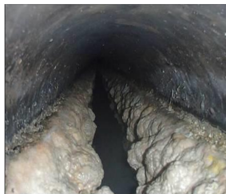
図6-2 油脂がたまった下水道管の内部
