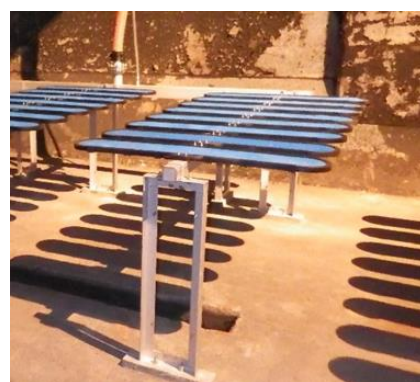
図6-3 成瀬クリーンセンターの高効率散気装置
