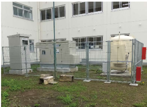
既存発電設備
