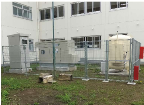
既存発電設備
