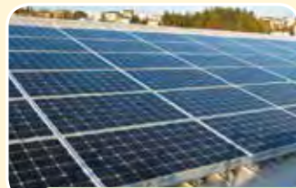
町田市立小・中学校の中では最大 となる、30kWの太陽光発電パネル
